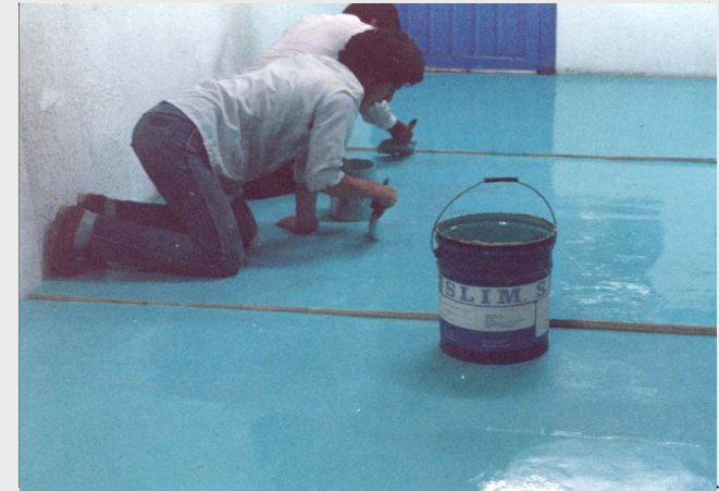
Epoxy Floor Coating aplicado en 5° nivel, ductos 1, en el Hotel Sheraton Ma. Isabel . 1,500.00 M2. México; D.F. Año 1990.
