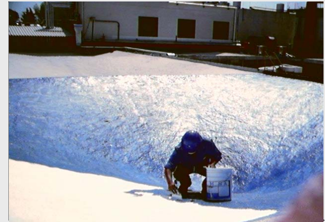
Seal Roof 2500-S , aplicado en Laboratorios Merck Sharp & Dohme de Mexico S.A. de C.V. Zona Mezaninne. 1,875.00 M2. año 2000.
